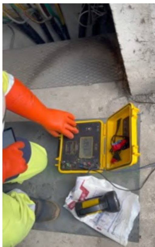
Contrôle d'une valeur du circuit de terre dans un poste de distribution publique
