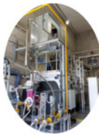
Expérimentation chaudière CH0C Villers-Saint-Paul (Oise)
