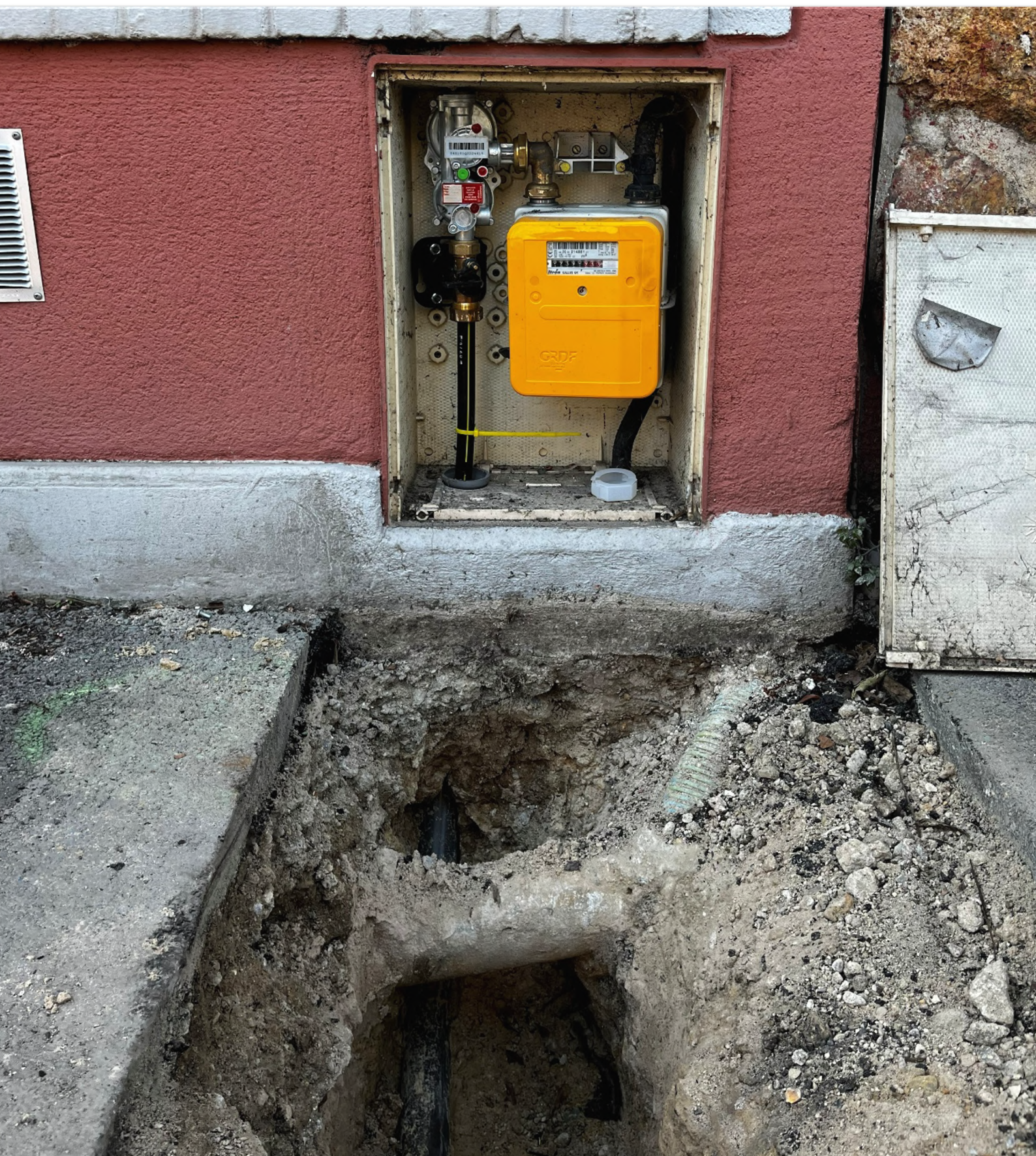
Raccordement gaz d'un coffret client équipé d'un robinet d'arrêt, d'un détendeur et d'un compteur Gazpar.
