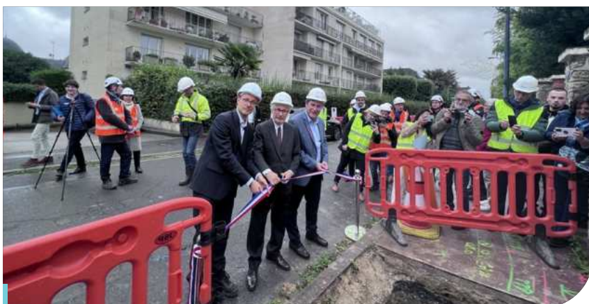
Pose de la première canalisation en polyéthylène biosourcé en Île-de-France en présence de Jean-Jacques Guillet, président du Sigeif, Sylvain Berrios, maire de Saint-Maur-des-Fossés, Bertrand de Singly, directeur clients territoires IDF GRDF - 23 octobre 2023
