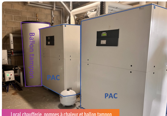
Local chaufferie, pompes à chaleur et ballon tampon.
