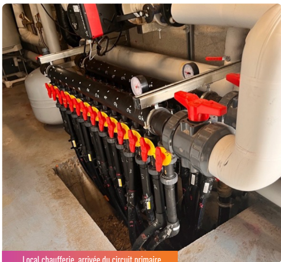
Local chaufferie, arrivée du circuit primaire.
