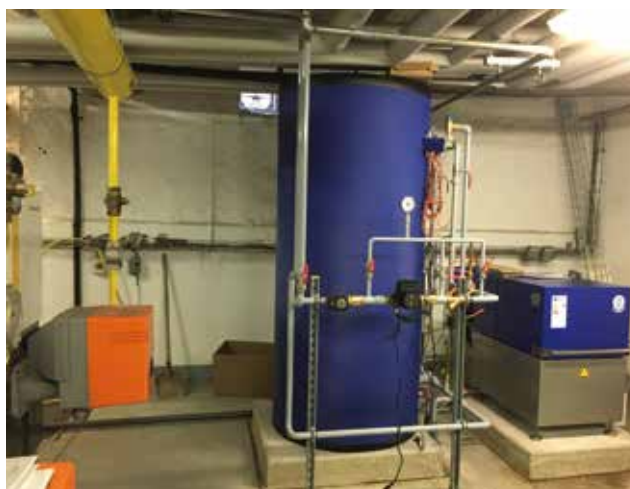
Vue de l'installation de l'école Paul-Bert à Antony, composée d'un module de micro-cogénération et d'un ballon tampon de stockage d'eau chaude sanitaire.
