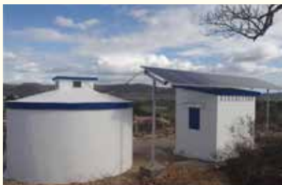
Château d'eau et installation de forage de la commune de Tanandava (Madagascar).
