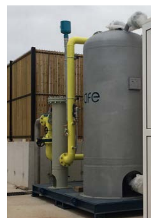
Unité de séchage du gaz.
